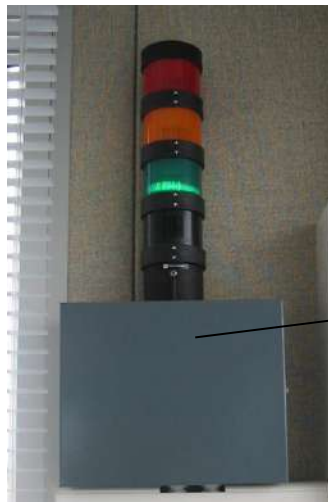
Alarme visuelle et sonore à l'intérieur du poste d'accueil et de contrôle
