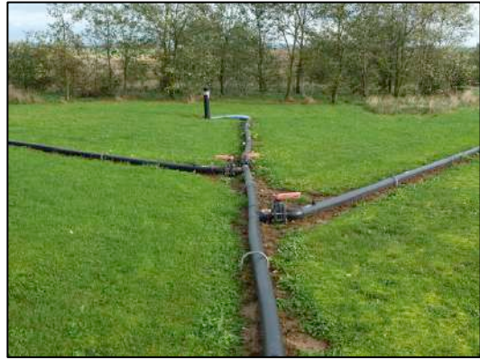
Photo 8 : Réseau de captage sur site réaménagé
