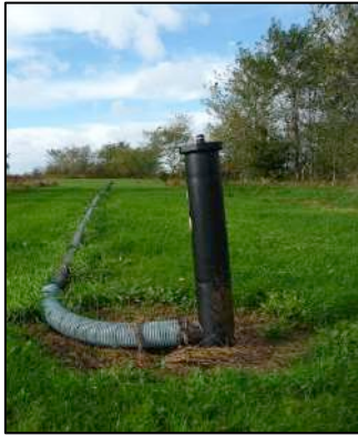
Photo 7 : Puits de captage de biogaz
